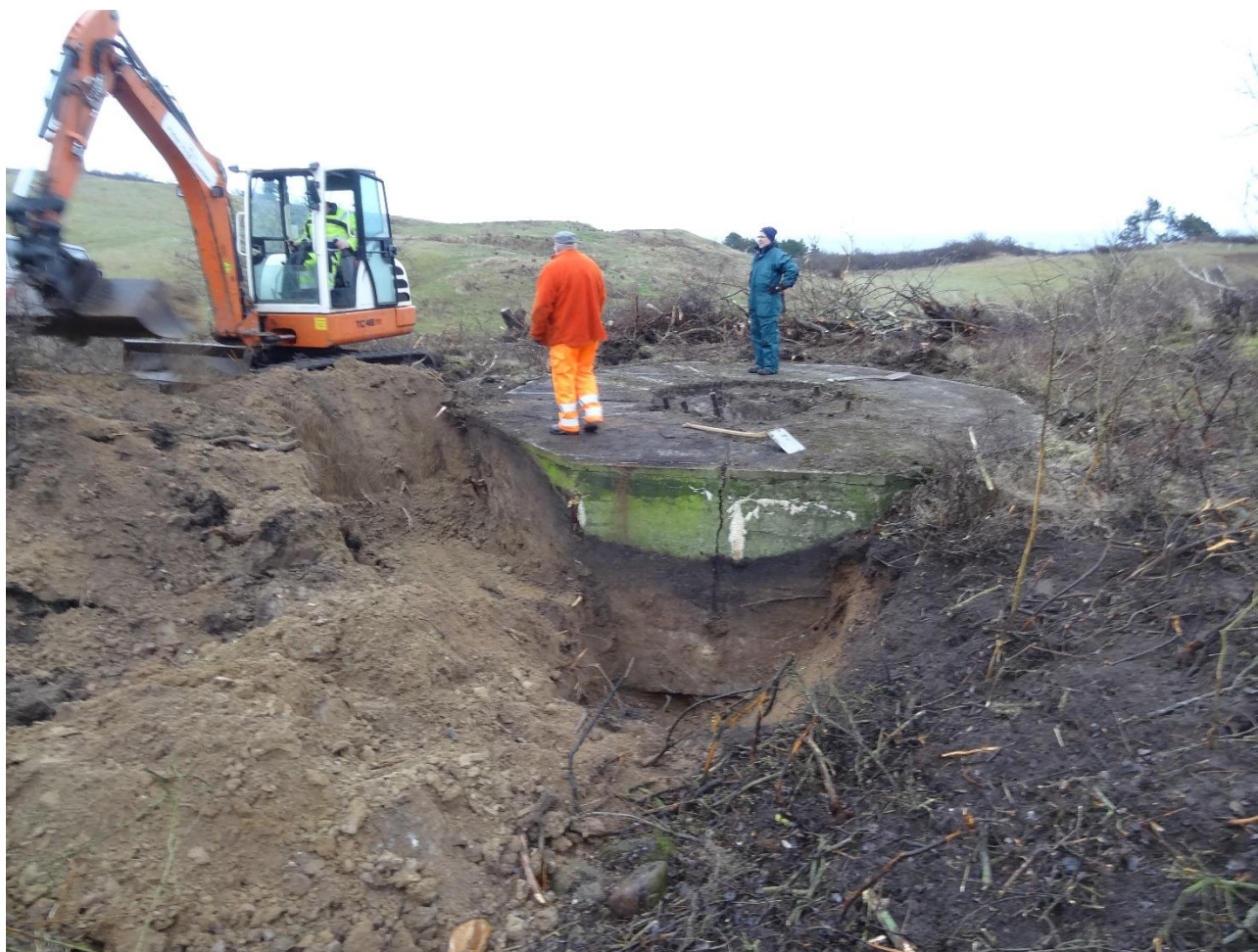
Kanonstilling under udgravning. Kanonen skulle monteres på de bolte, der stikker op omkring hullet i midten. Foto Sven Weel Jensen.
